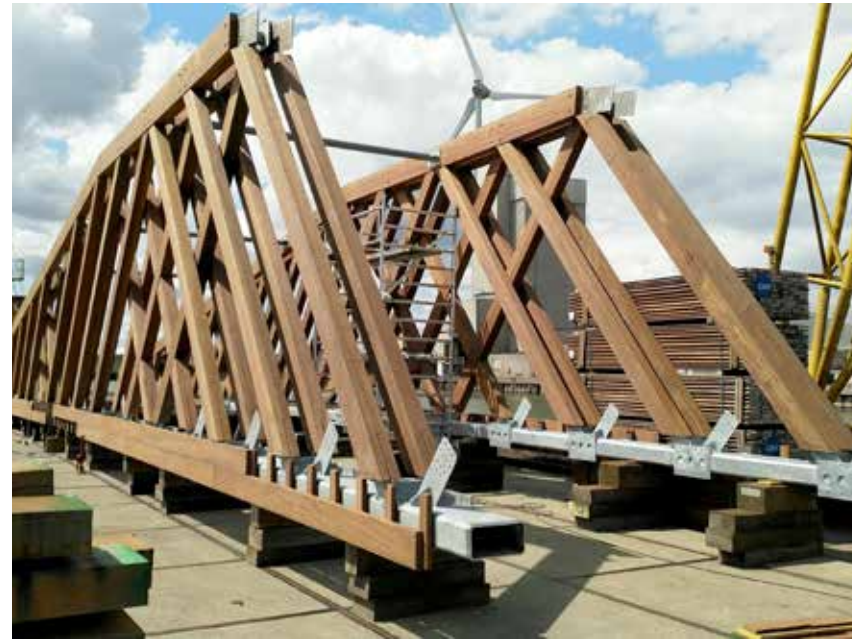
Duurzame brug uit verantwoord hout.
